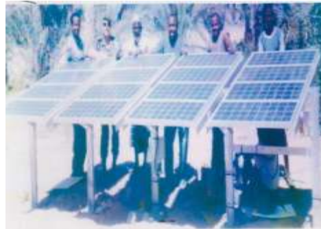
Pompe solaire à As-Aila
